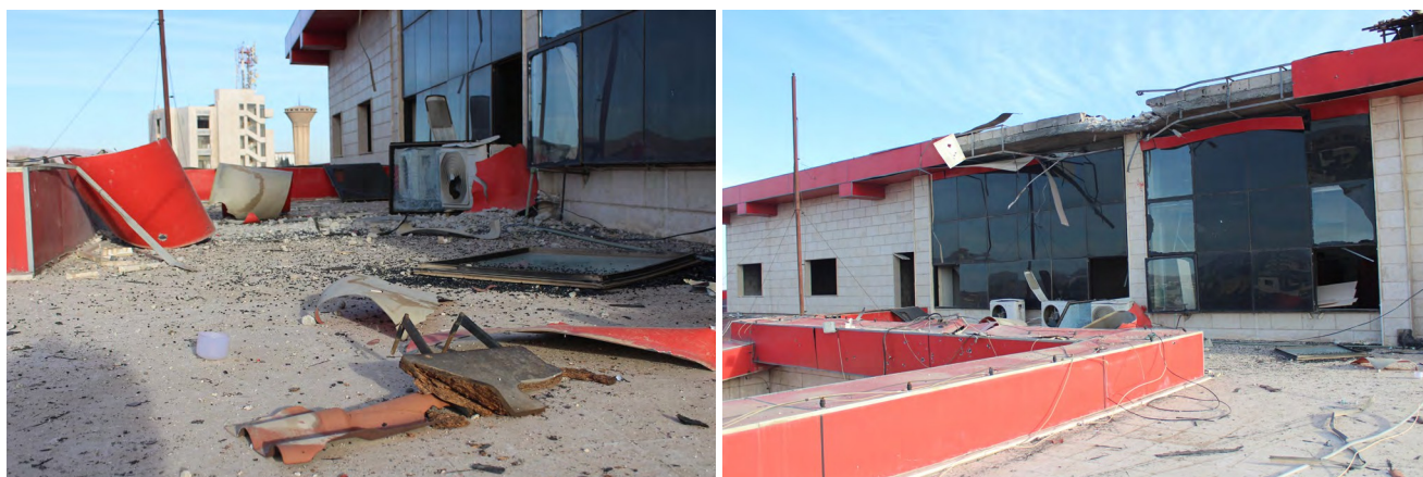
Daños en el Hospital de Prótesis de la Media Luna Roja Kurda en Qamishlo tras el ataque con drones perpetrado el 20 de enero de 2026 [33] (Centro de Información de Rojava)
